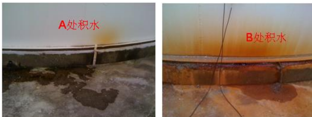
图 6：储罐底部两处积水
